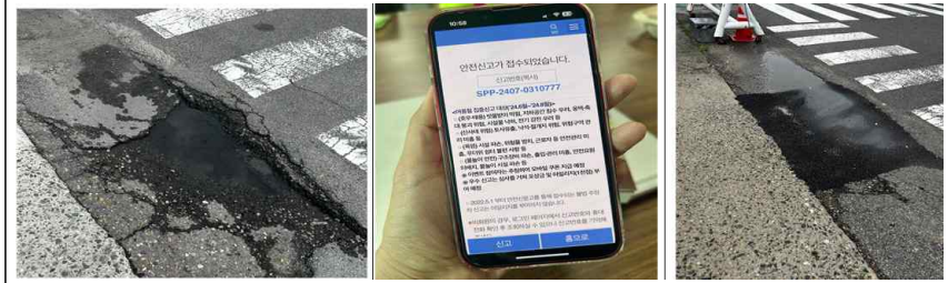
(위험) 교문 앞, 주 통학로 도로 패임 (과정) 안전신문고 활용 신고 (결과) 도로 수리 완료됨 (이유) 폭우 시 물웅덩이 생김, 자전거 이용 등하교 학생 걸림 위험
